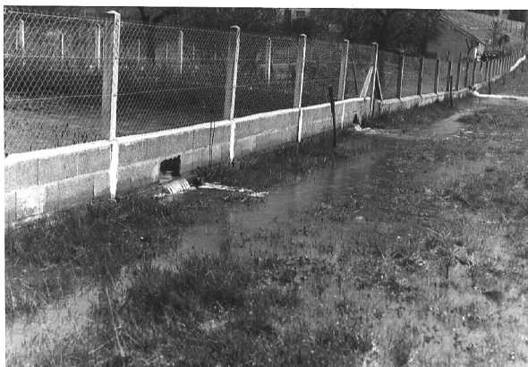
Photo A : Ecoulement en 1978 depuis le mur du n°38 Val-Saint-Quentin :
